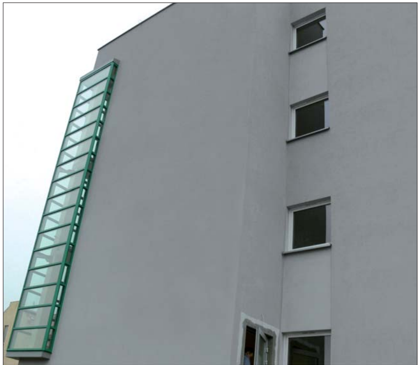
Przebarwienia wskutek wykonania prac malarskich w obniżonych temperaturach
